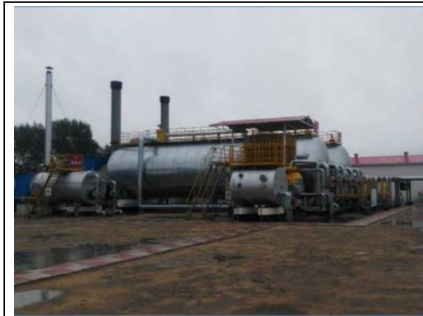
塔一转油站四合一装置
