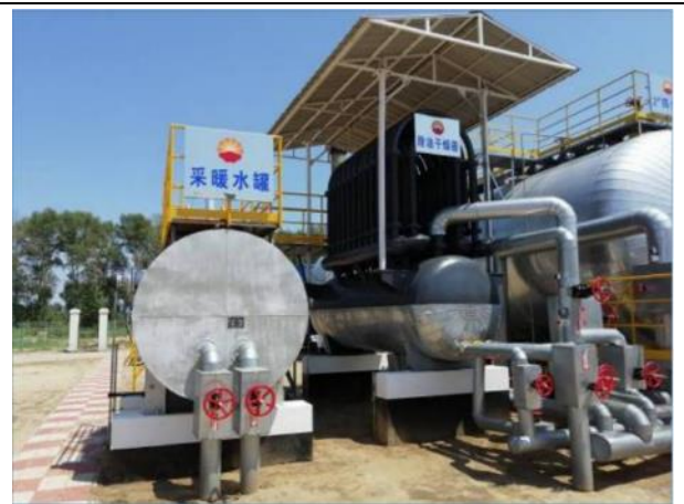
塔一转油站除油干燥器
