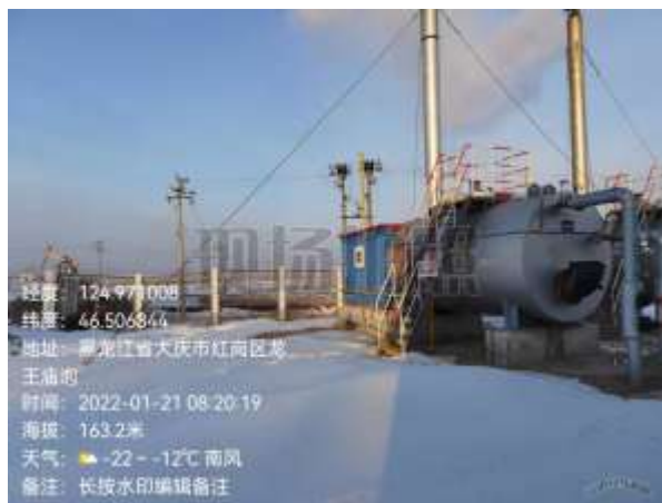
南二十三含油污水深度站 1#加热炉
