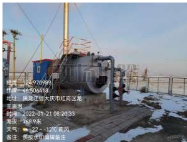
南二十三含油污水深度站 2#加热炉
