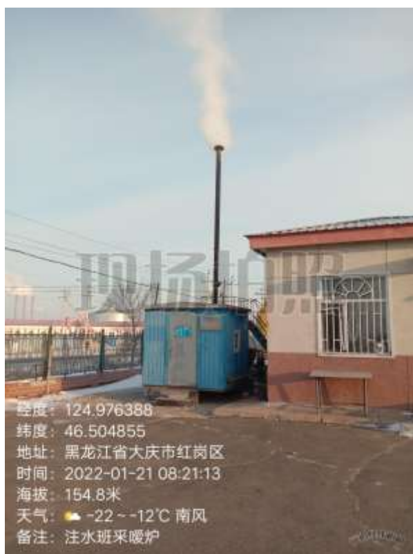
南二十三注水变电队 1#加热炉
