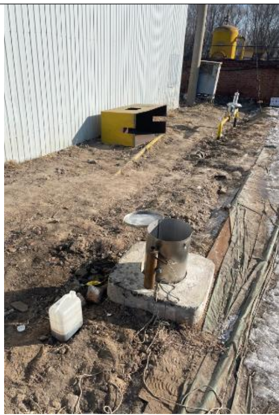
地下水监测井
