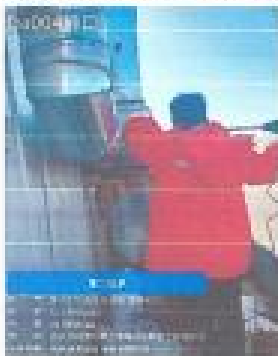
排气筒 (DA004) 处理前
