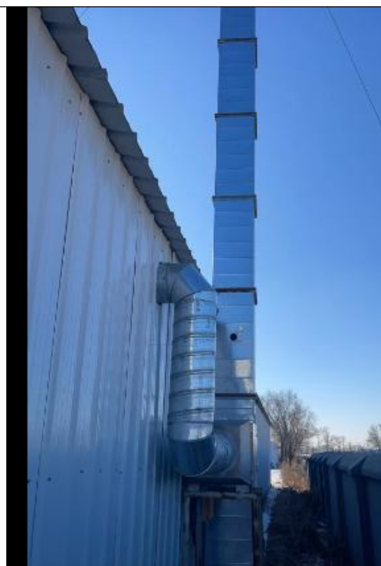
危废间排气筒
