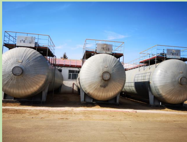
图 3.10-7 葡二联脱水站站况现状
