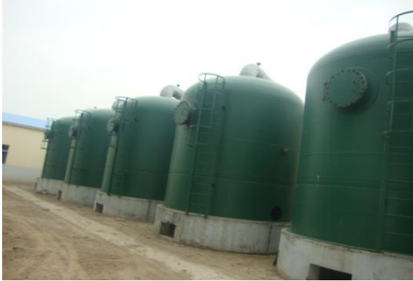
朝一联合含油污水深度处理站罐区现状
