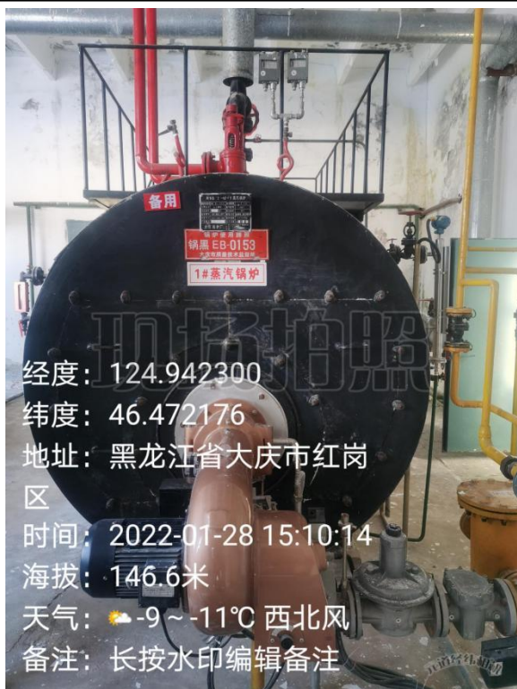
四区含油污泥处理站 1#加热炉
