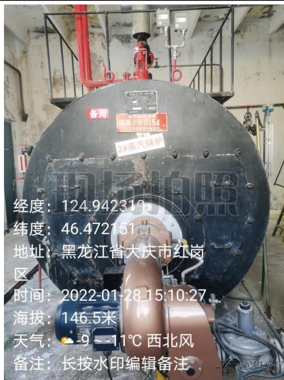
四区含油污泥处理站 2#加热炉
