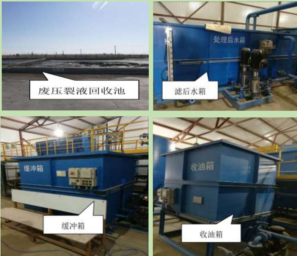
图 3.10-13 杏十三-1 压裂液处理站现状图
