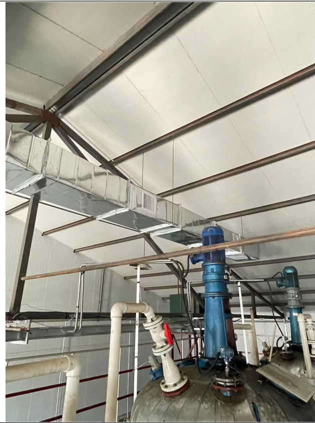
废气收集装置
