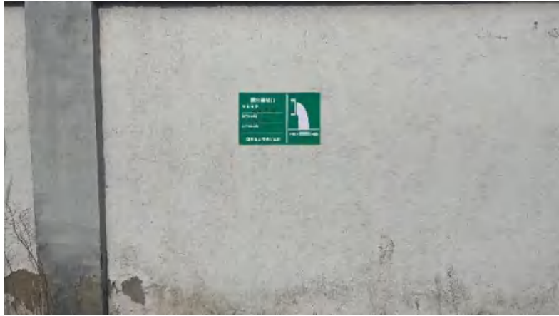
雨水排放口标识
