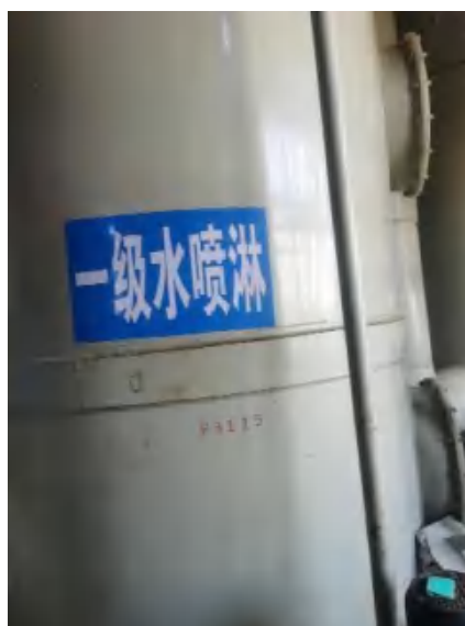
三车间废气处理装置
