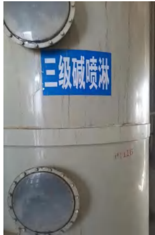
二车间废气处理装置
