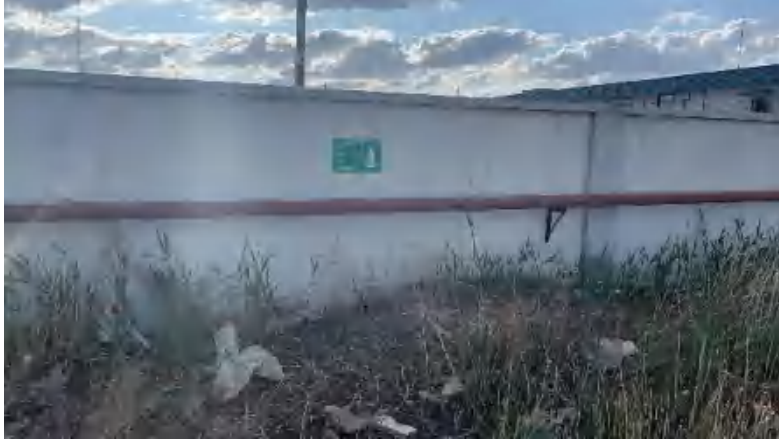
污水排放口标识
