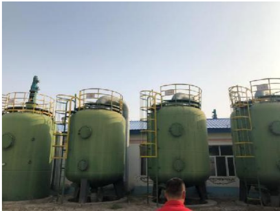
宋一联污水处理站滤罐
