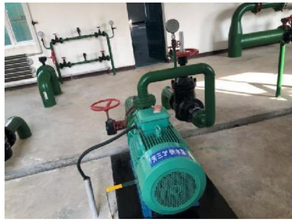
宋一联污水处理站供水泵
