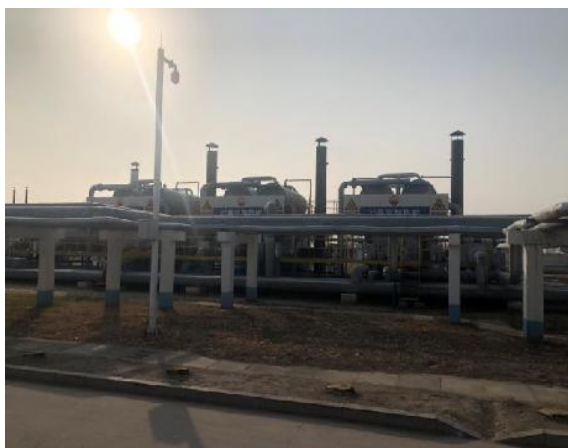
宋一联脱水站加热炉现状
