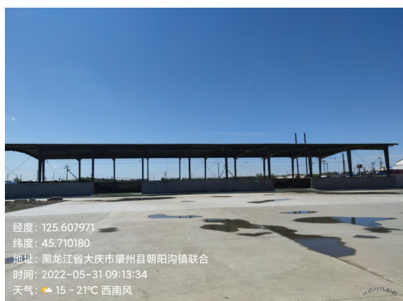
含油污泥存放场现状
