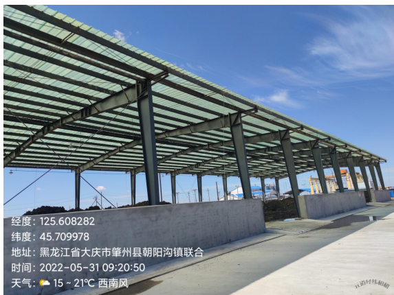
含油污泥存放场现状
