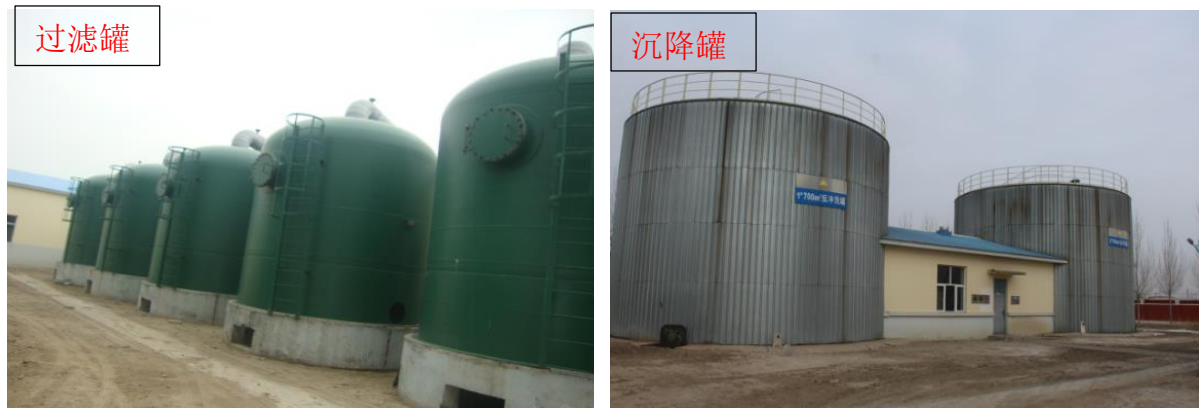
图 4-10 朝一联合含油污水深度处理站现状
