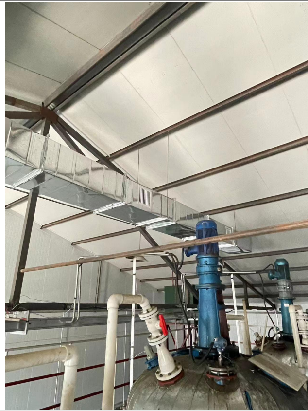
废气收集装置
