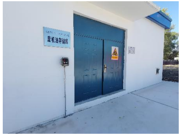
废机油存储库
