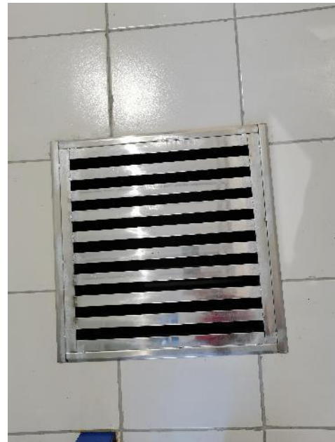
易燃品存储库收集池
