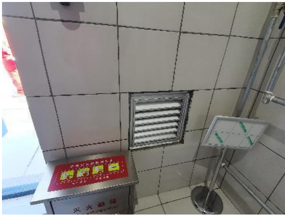
墙侧面自然排风
