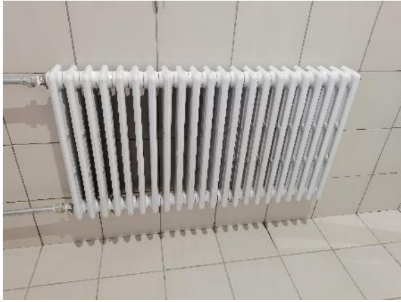
库房内取暖设施
