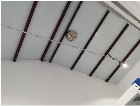
棚顶自然排风扇
