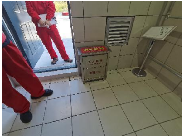
墙侧面自然通风设备
