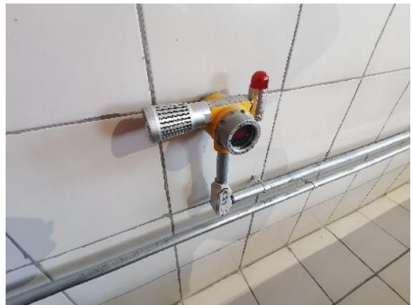
废机油存储库可燃气体报警器
