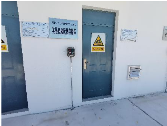
进入库房之前的排风按钮
