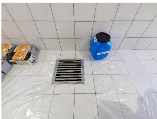
废电瓶存储库收集池
