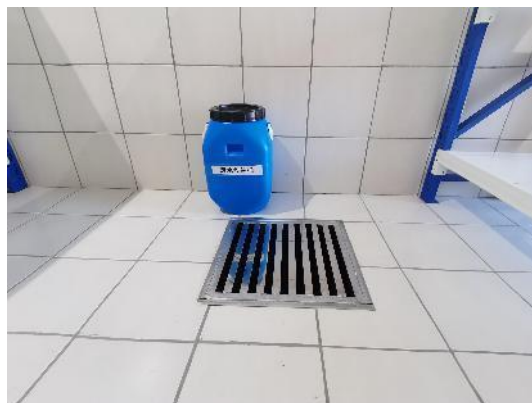
毒害品存储库收集池
