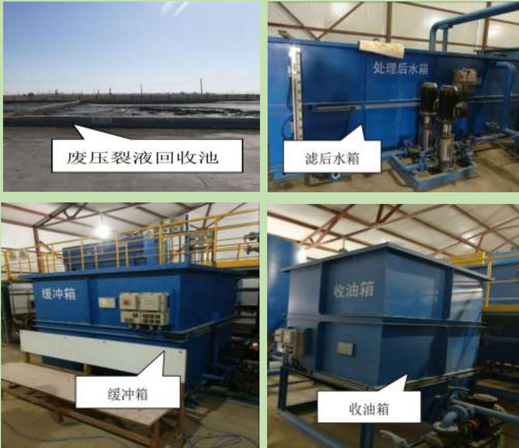
图 3.9-13 杏十三-1 压裂液处理站现状图
