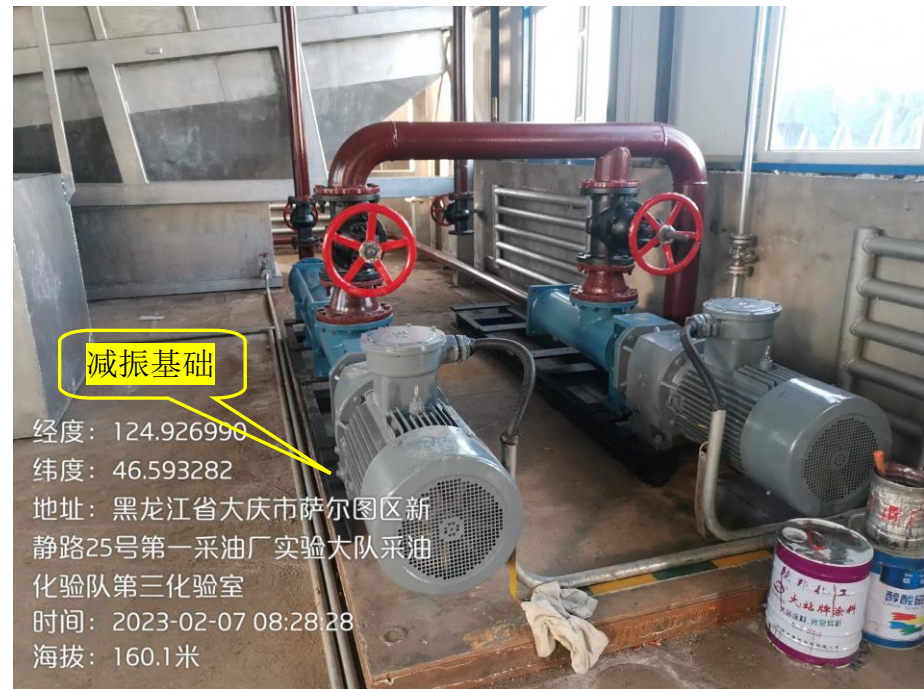
图 4-7 新建预处理间提升泵及减震基础现状
