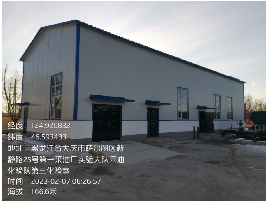
图 4-6 新建厂房隔声门窗窗及隔声墙体现状
