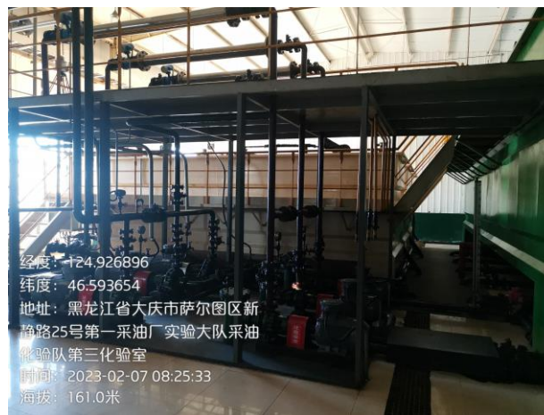
图 4-3 密闭集输系统现状
