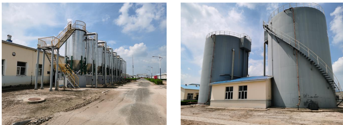
图 3.9-6 朝一联含油污水深度处理站现状
