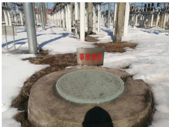
事故油池情况
