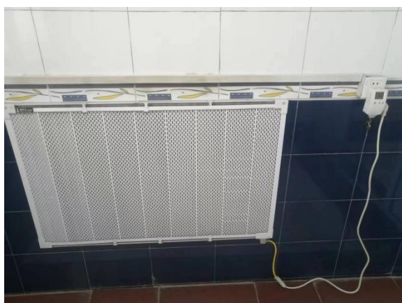
站内电采暖情况（电暖气）
