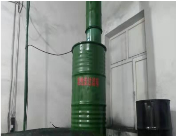
螺纹密封脂生产排气筒
