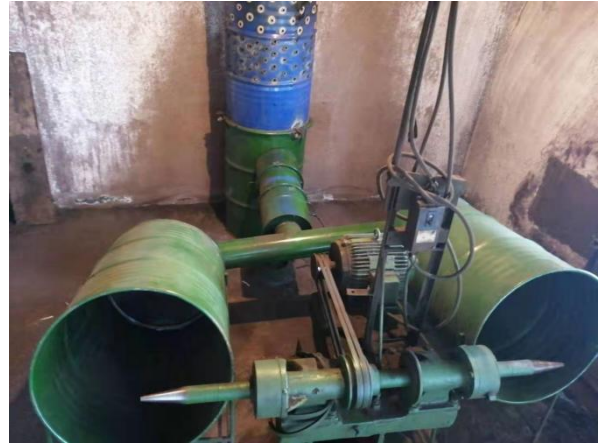
金属打磨车间的布袋除尘器
