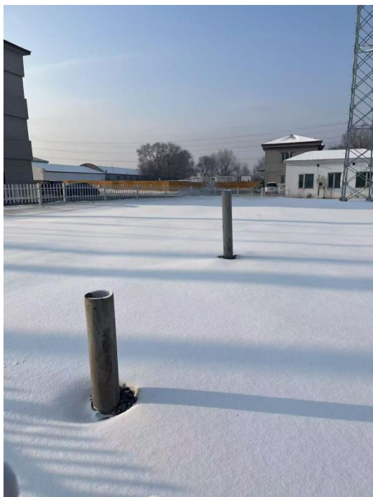
事故油池排气管 (2024. 12)
