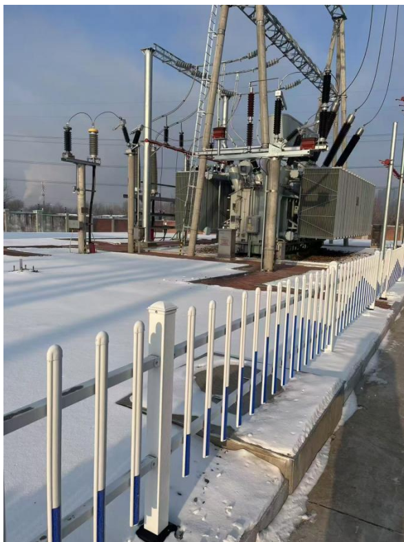
项目 3 号主变现状 (2024. 12)
