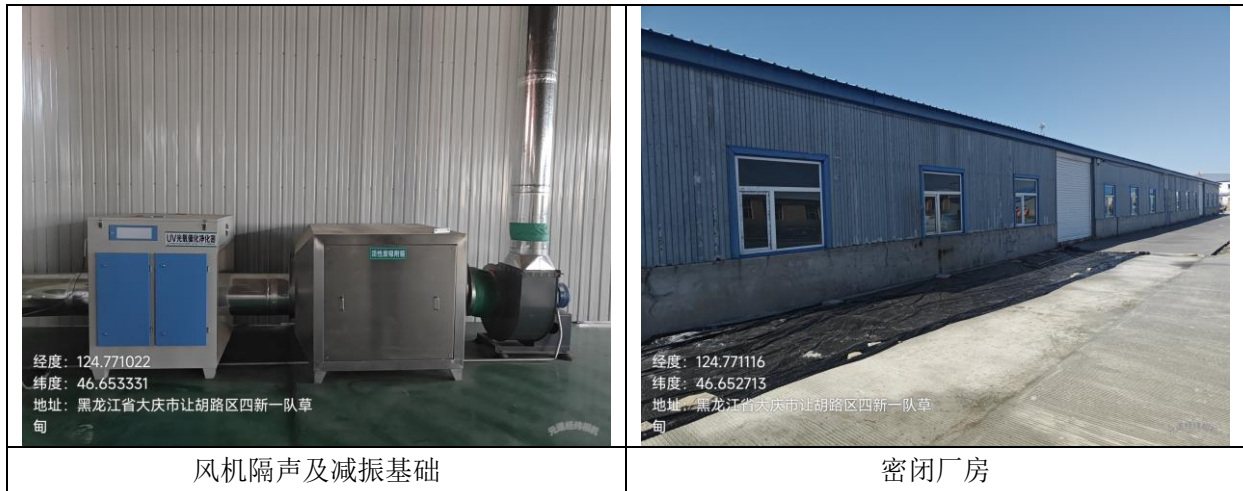
图 4-6 噪声治理设施图片
