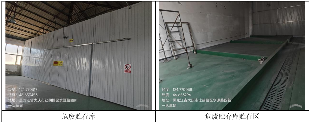
图 4-7 固体废物治理设施图片
