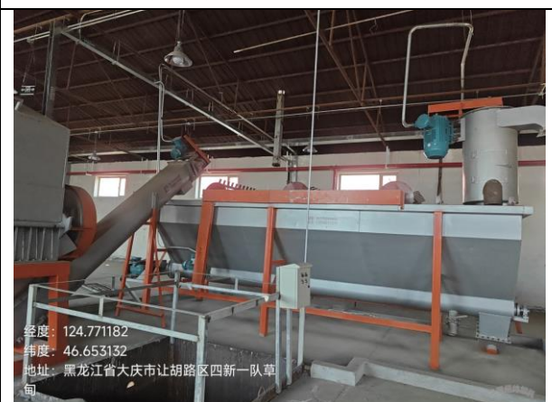
喷淋除尘系统及喷淋废水沉淀池
