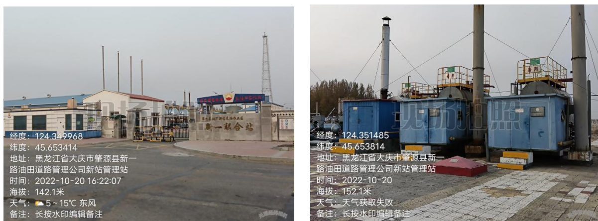
图 3.9-6 新一联脱水站现状
