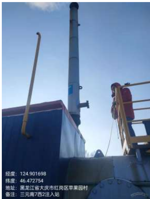
8-6 队南七西二注入站 1#加热炉
