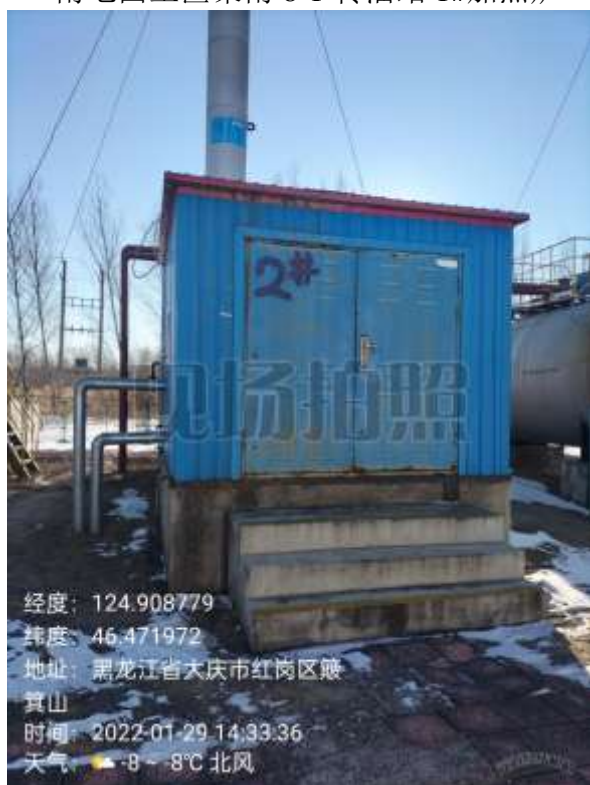
注水变电队南 7-2 污水站 2#加热炉
