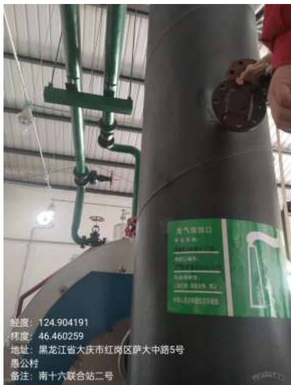
采油 8-6 队南十六联合站 2#锅炉采样口
