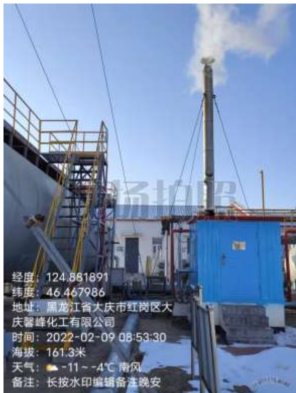
南七西工区聚南 8-1 转油站 1#加热炉
