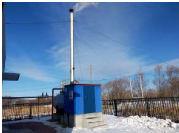
第三作业区维修队 1#加热炉
