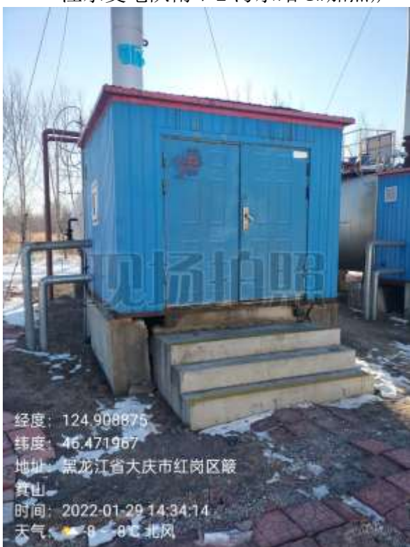
注水变电队南 7-2 污水站 3#加热炉
