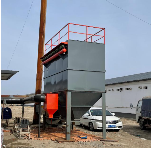
生物质锅炉除尘设备及烟囱
