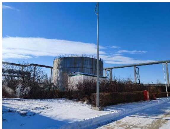
8000m 3 的事故缓冲罐及集水池（地下）
