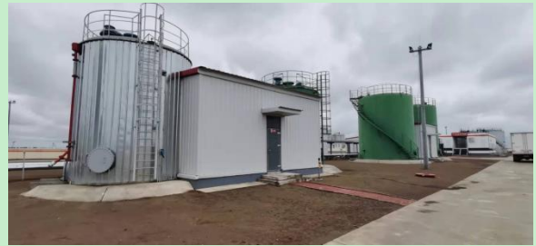
污油罐及缓冲罐
