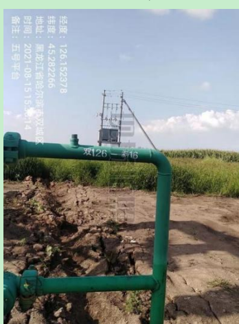
5#平台井场柱上变电站
