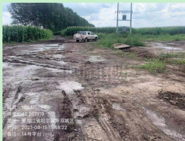
14#平台井场柱上变电站
