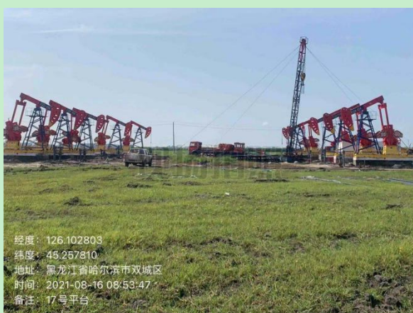
17#平台井场现状
