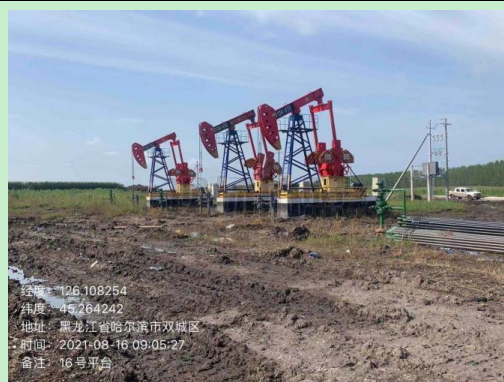
16#平台井场现状
