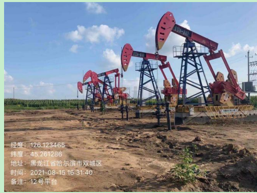
12#平台井场现状
