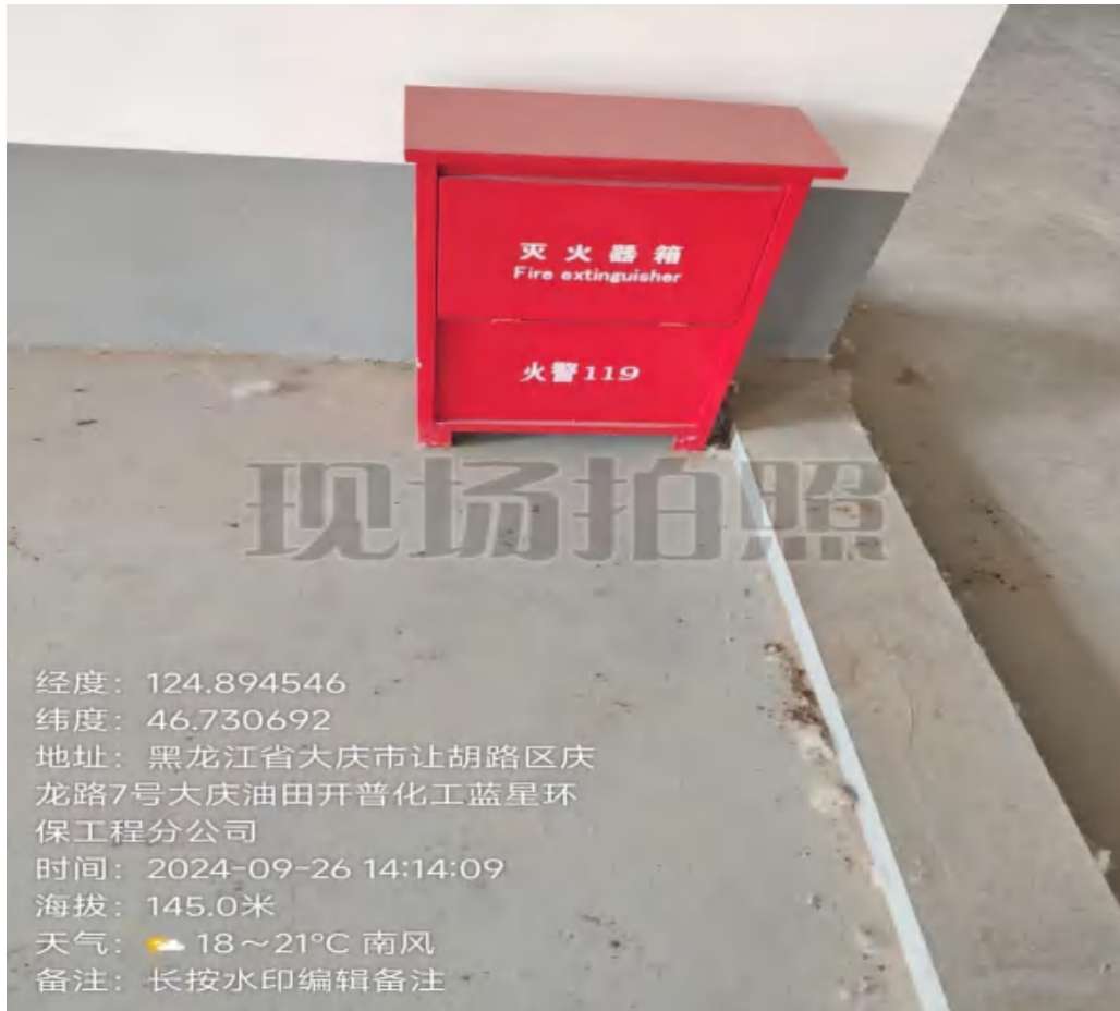
废润滑油桶贮存间灭火器
