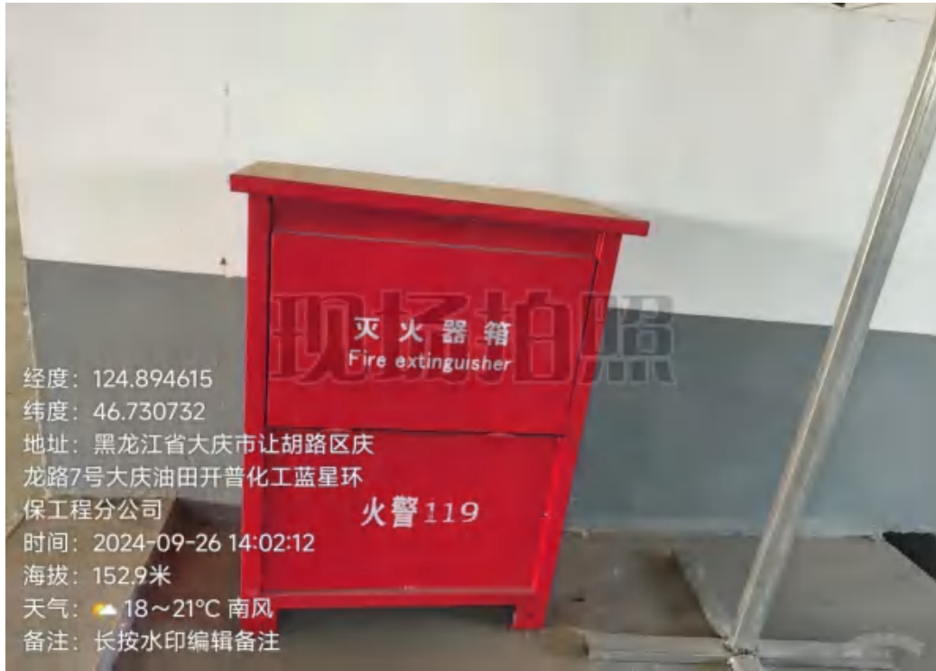
含油防渗布存储区灭火器
