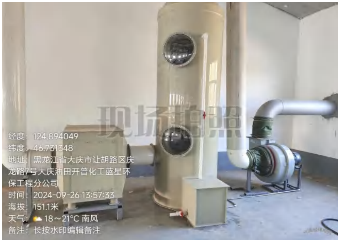
负压排气系统+活性炭吸附装置+碱液吸收装置
