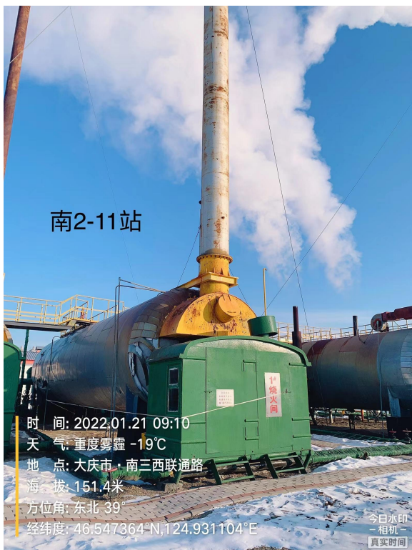
采油 44 队南 2-11 站 1#加热炉
