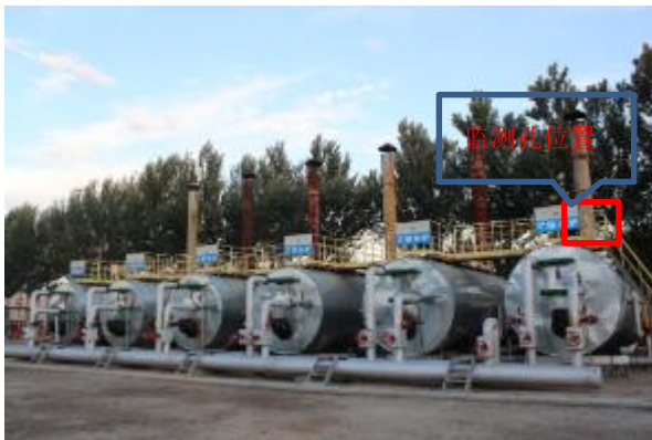
朝一联合站加热装置区现状
