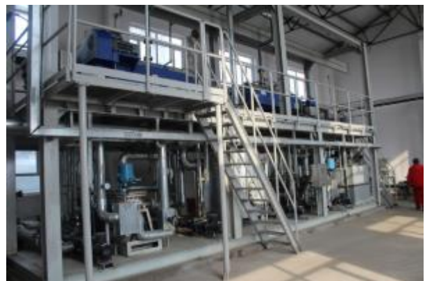
朝一联合含油污泥处理站污泥离心处理装置
