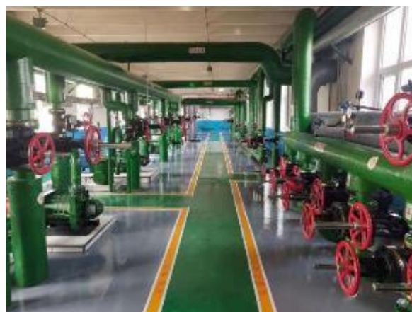
朝四联转油站油岗泵房现状
