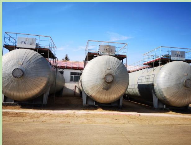
图 3.10-5 葡二联脱水站站况现状
