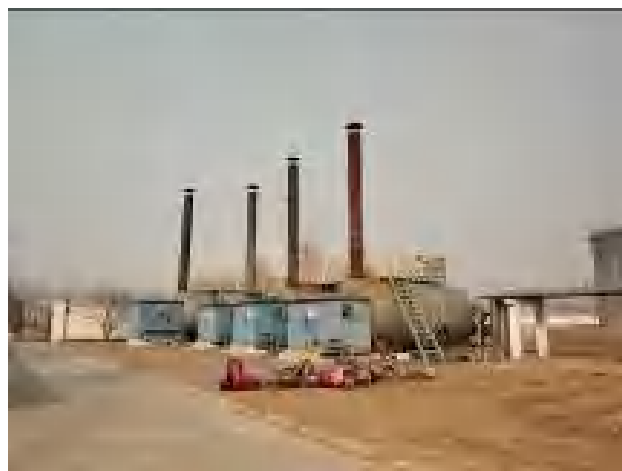
芳深 2 转油站加热炉现状
