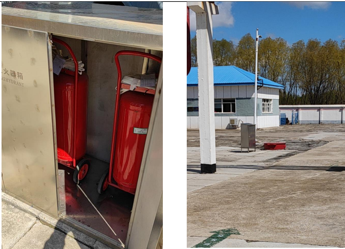
站内消防设施
