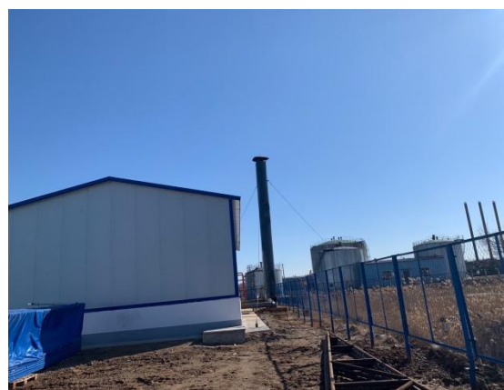
燃气锅炉 15m 高排气筒
