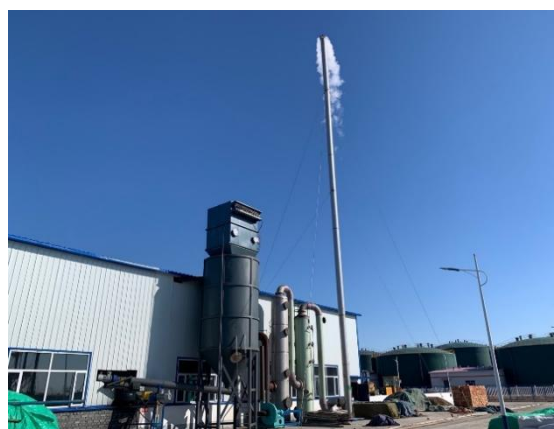
热解炉喷淋塔和 30m 高排气筒
