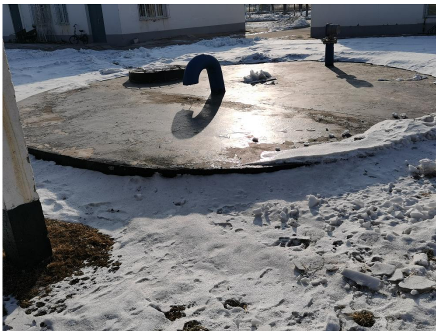
图3-1 生活污水防沉淀池
