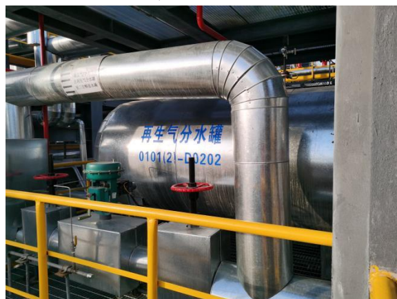
再生气分水罐
