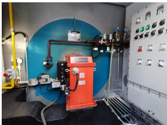
导热油炉内部
