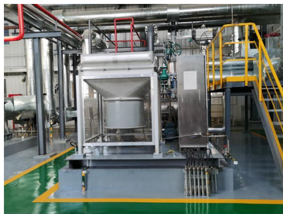
丙烷制冷机组
