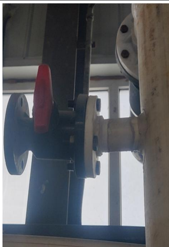
车间尾气监测口
