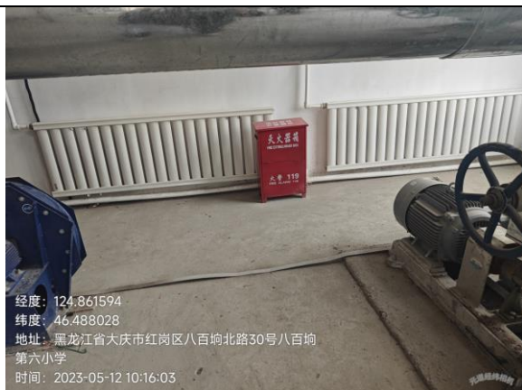
锅炉房灭火器箱
