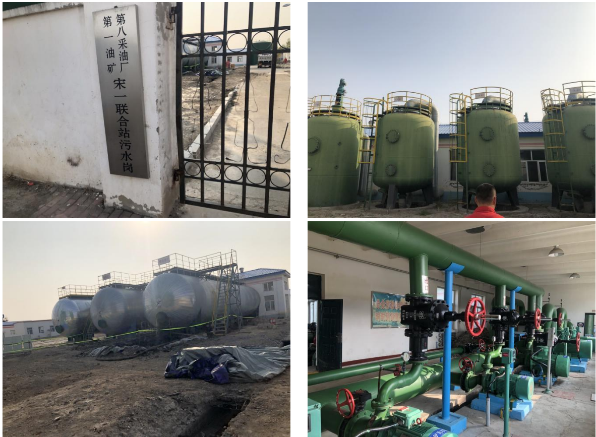
宋一联合油污水处理站现状
