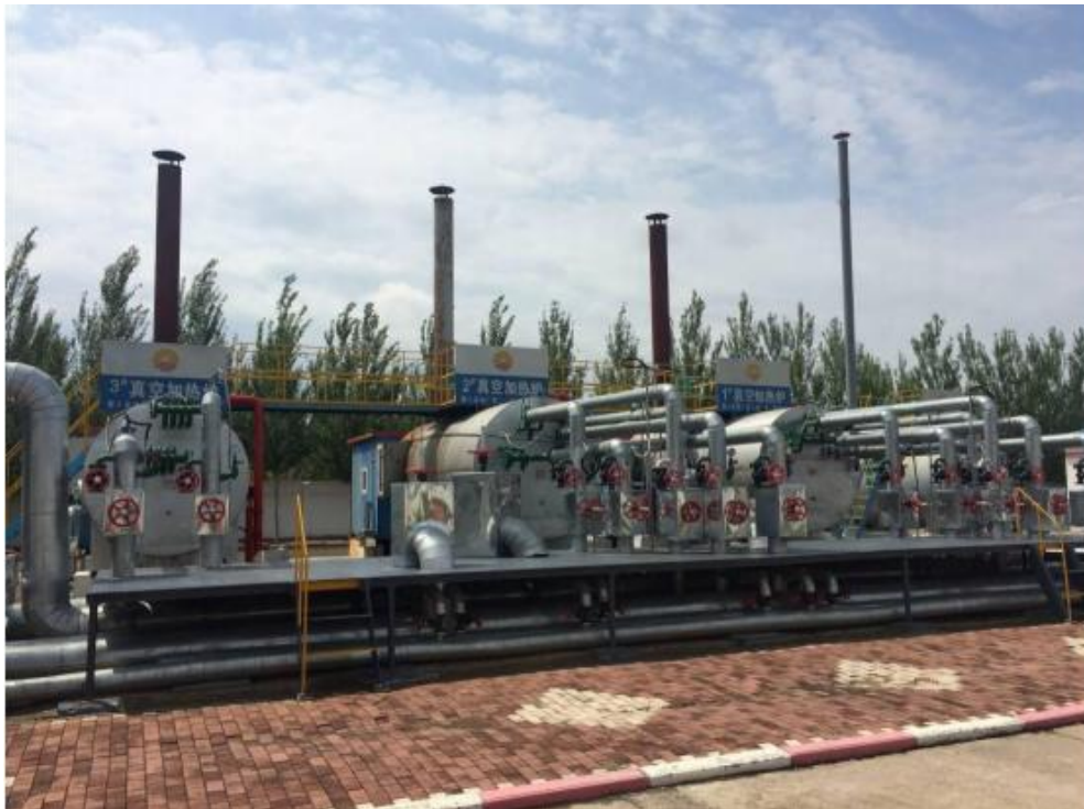
升四转油站现状
