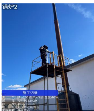
锅炉房生物质锅炉烟囱（DA002）
