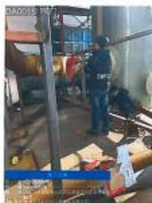
排气筒 (DA001) 处理前
