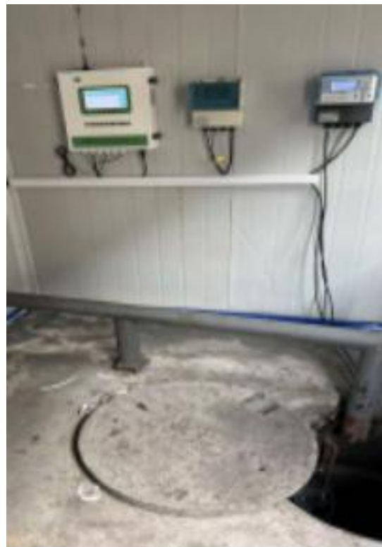
地下水监测井
