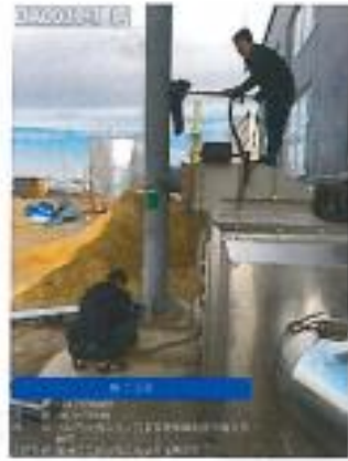
排气筒 (DA003) 处理后
