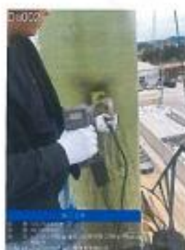
DA002 排气筒处理后
