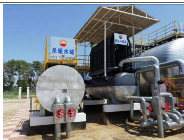
塔一转油站除油干燥器
