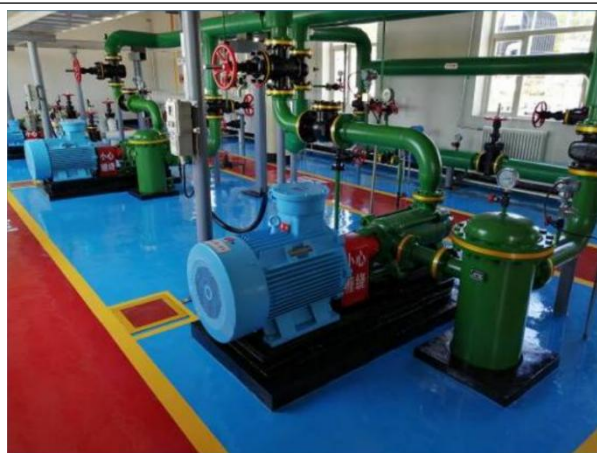
塔一转油站掺水泵
