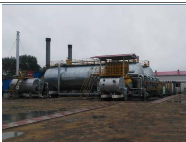
塔一转油站四合一装置
