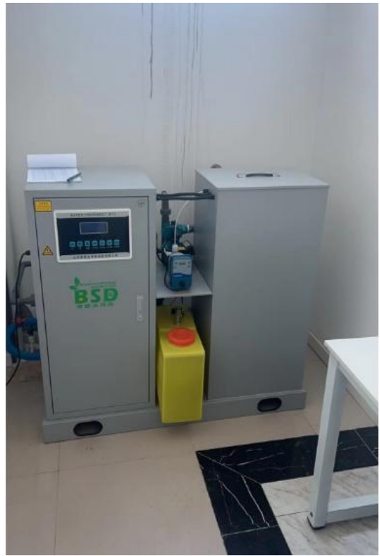
污水处理设备
