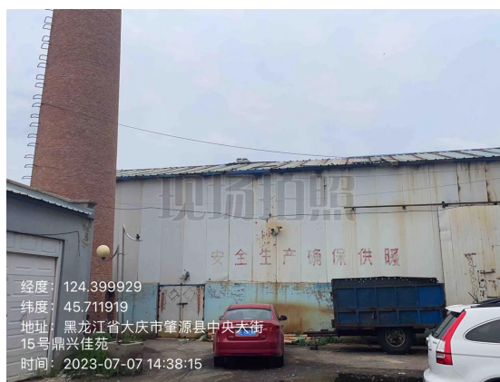
尚城名人苑锅炉房现状
