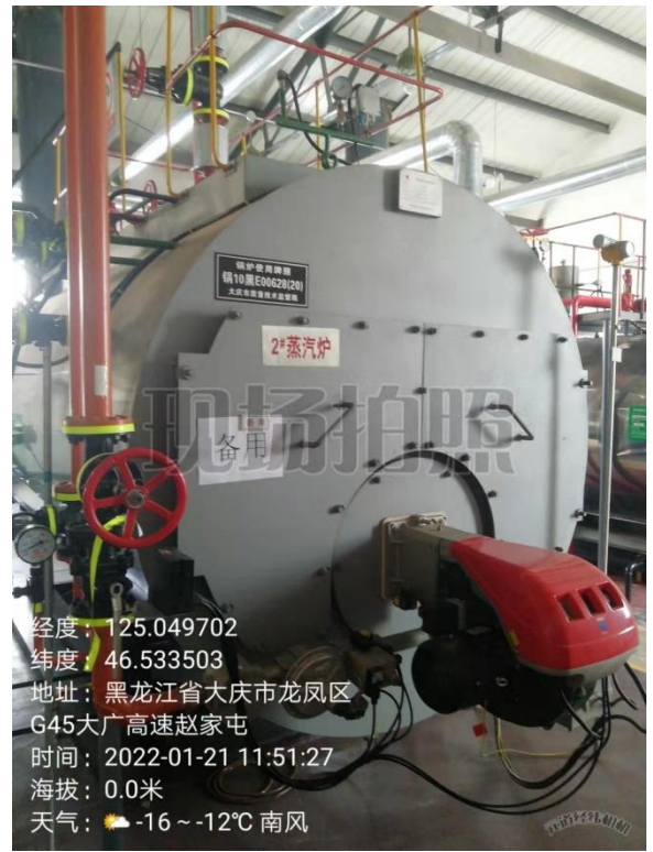
南七联合站 2#锅炉
