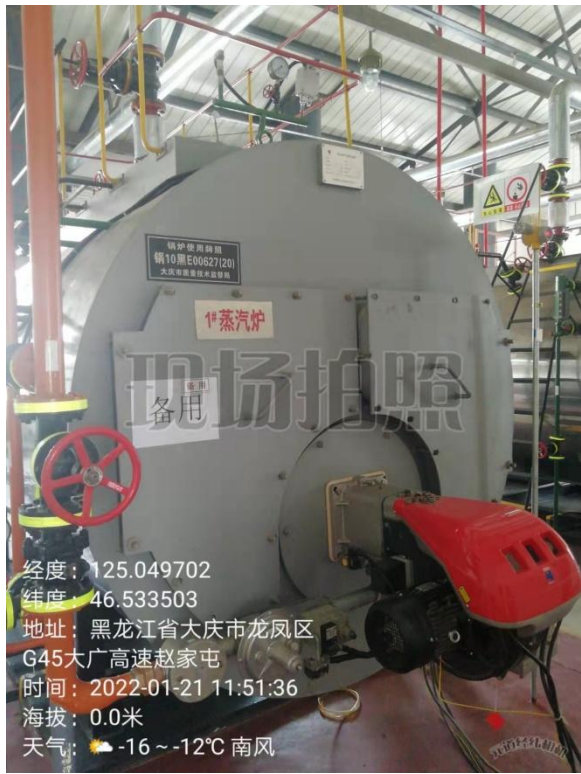
南七联合站 1#锅炉
