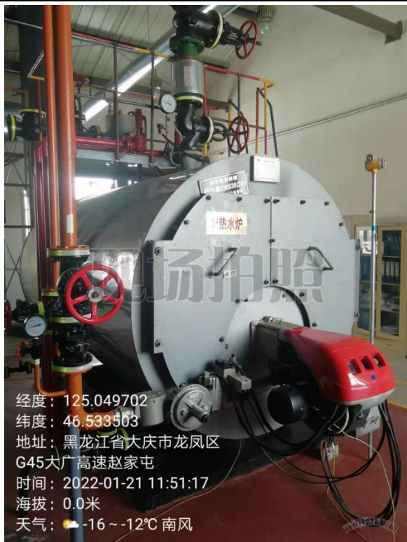
南七联合站 3#锅炉
