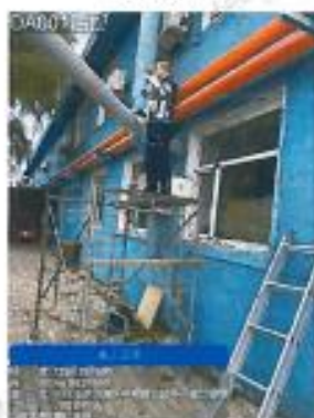
排气筒 DA001 处理后
