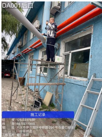
排气筒 DA001 处理后
