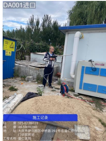
排气筒 DA001 处理前
