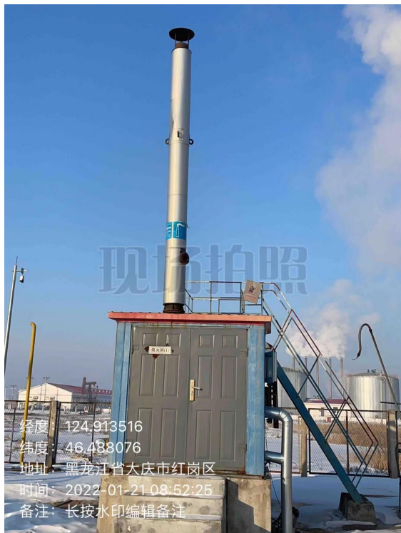
注聚八队六东 3#注入站 1#加热炉现状
