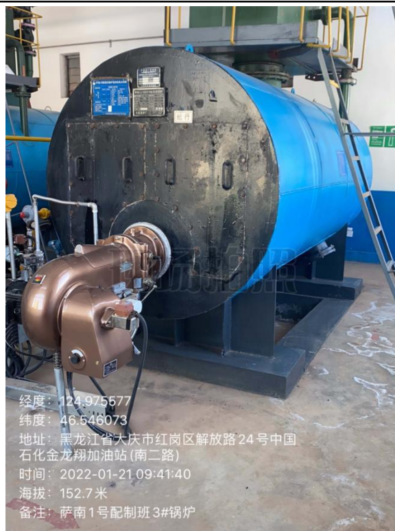
第七作业区 1#配制站 3#锅炉现状
