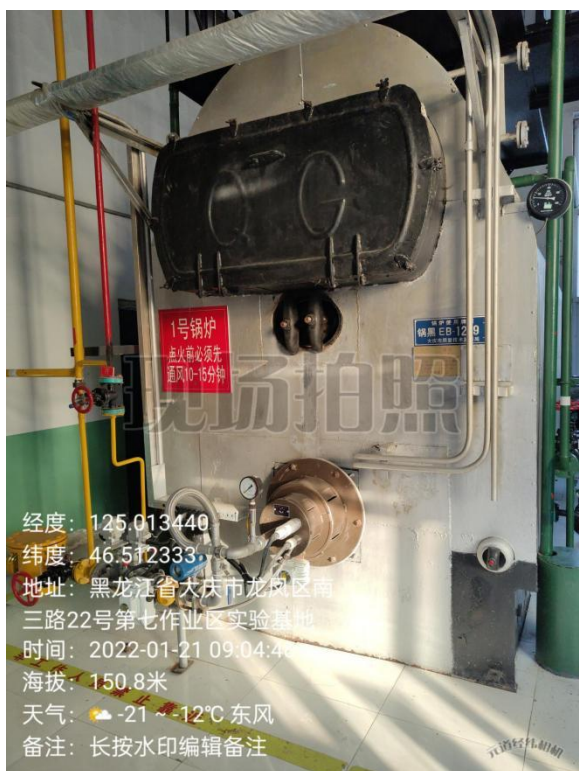
第七作业区试验一队 1#锅炉现状
