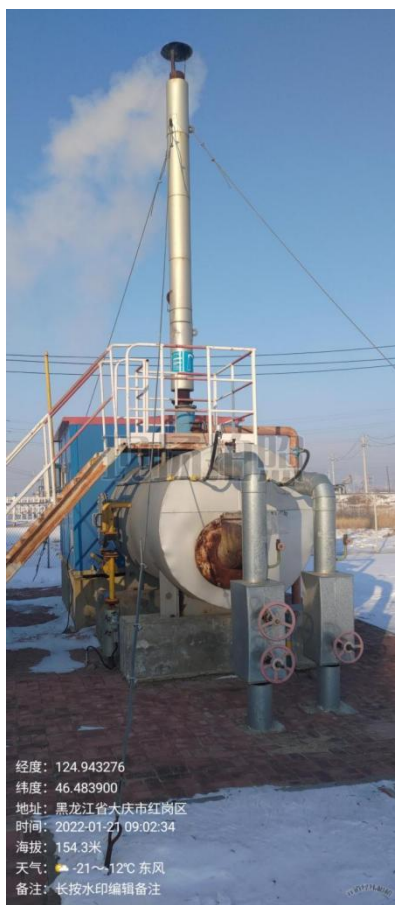
注聚八队南六东二元站 2#加热炉现状
