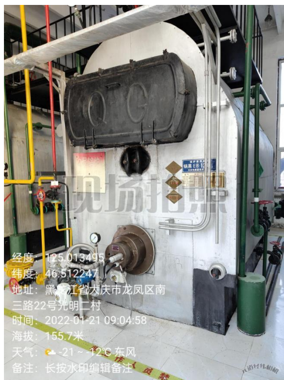
第七作业区试验一队 2#锅炉现状（目前停运）
