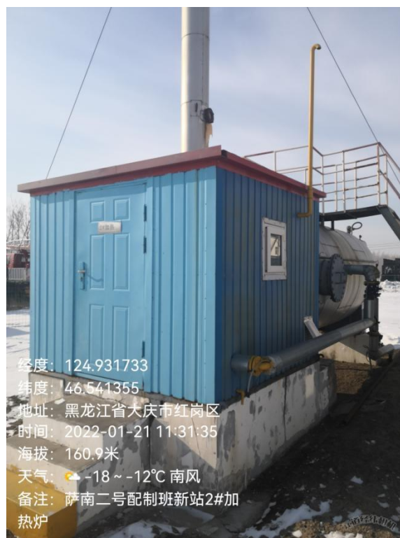
第七作业区 2#配制站新站 2#加热炉现状
