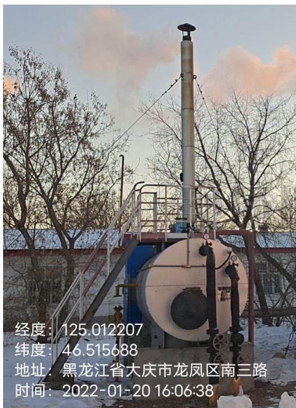
第七作业区维修队 1#加热炉现状
