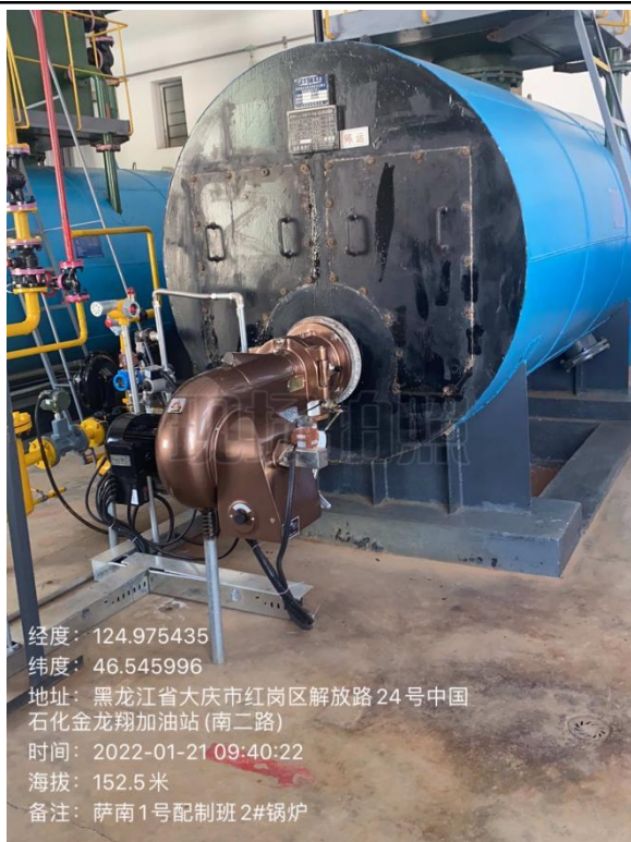
第七作业区 1#配制站 2#锅炉现状
