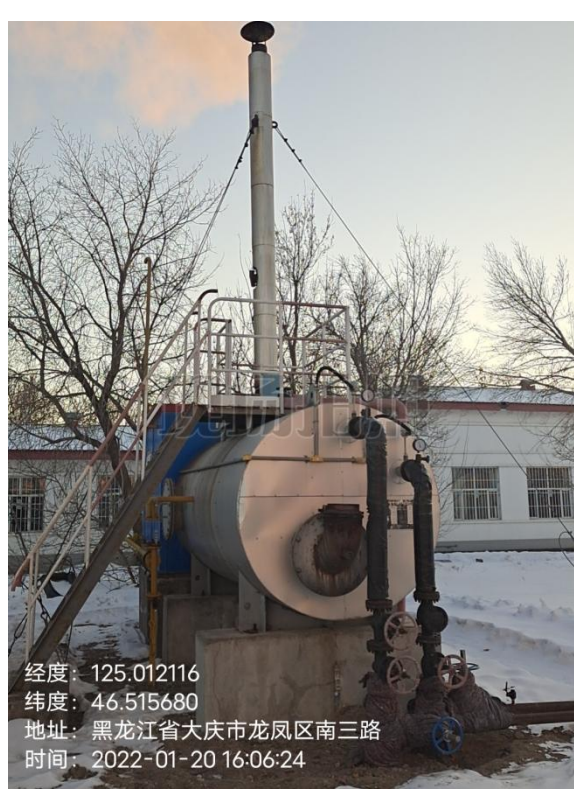
第七作业区维修队 2#加热炉现状
