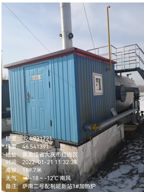
第七作业区 2#配制站新站 1#加热炉现状
