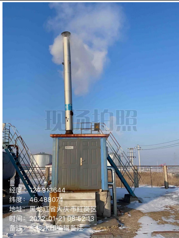
注聚八队六西 4#注入站 2#加热炉现状
