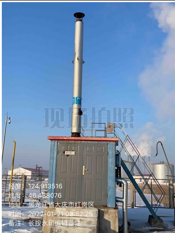
注聚八队六西 4#注入站 1#加热炉现状
