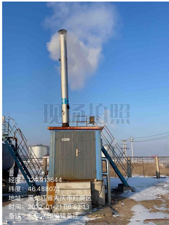
注聚八队六东 3#注入站 2#加热炉现状
