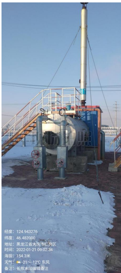
注聚八队南六东二元站 1#加热炉现状
