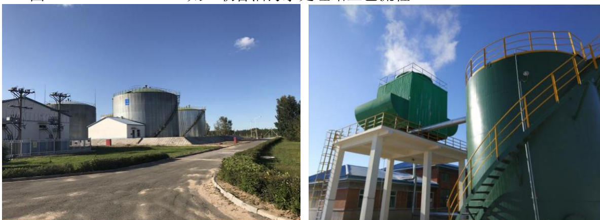
图 3.9-7 太一联合含油污水处理站现状图
