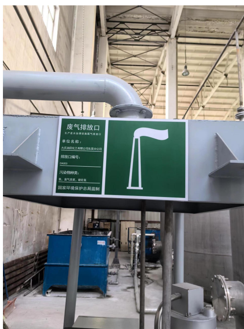
废气排放口标识
