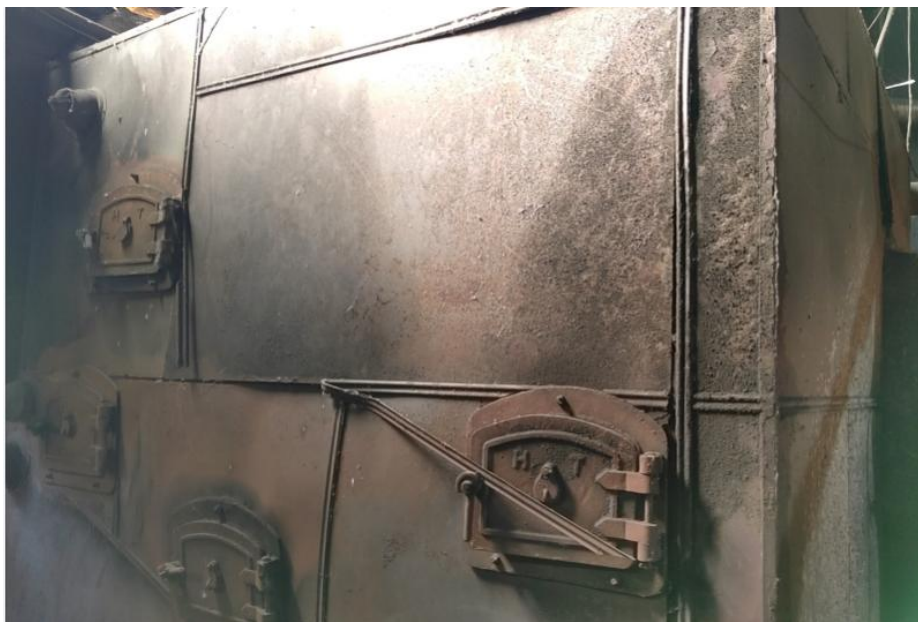
6t/h生物质锅炉（备用）
