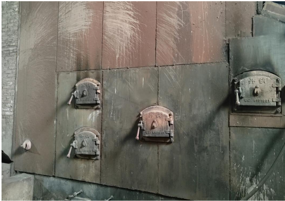
8t/h生物质锅炉
