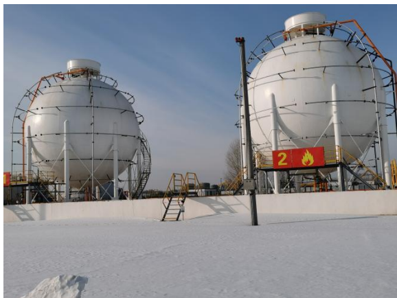
2 座模拟天然气储罐
