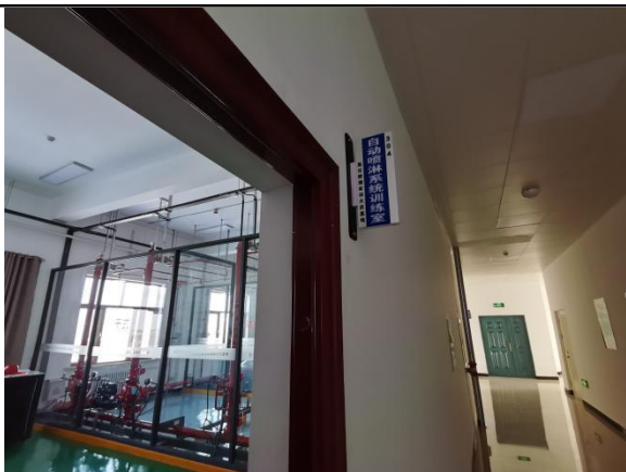
自动喷淋系统训练室
