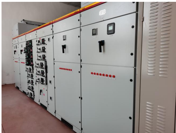
新增低压配电柜
