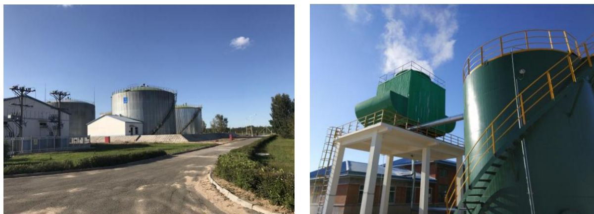
图3.8-6 太一联合油污水处理站现状图
